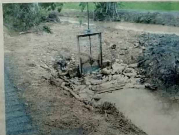
SATU daripada tali air yang tidak disenggara di kawasan Guar Sanji di Arau. Perlis dipenuhi sampah menyebabkan aliran air tersekat.
