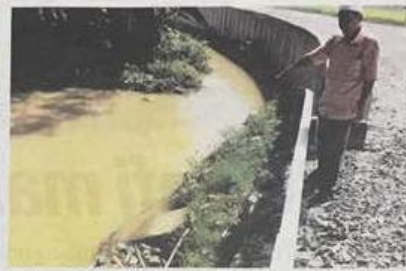
Soad menunjukkan terowong saliran yang masih digunakan untuk mengeluarkan air dari kawasan sawah.
